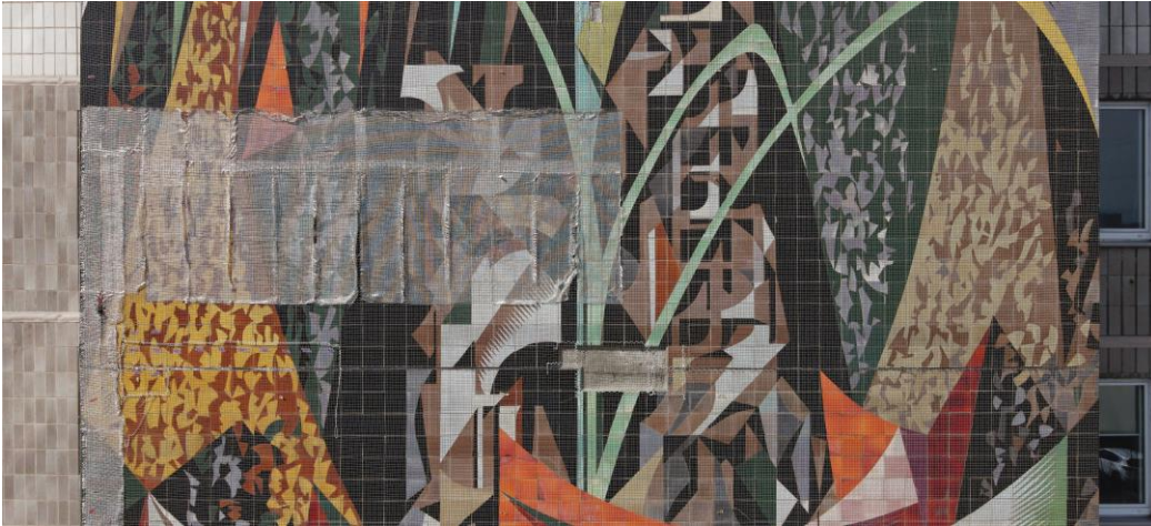
Josep Renau: Wandmosaik „Einheit der Arbeiterklasse und Gründung der DDR“ in Halle-Neustadt (1974), Schadensbild 2022, Foto: Thomas Wolf © Wüstenrot Stiftung
