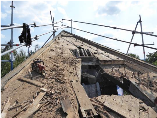
Sonnensegel Dortmund von Günter Behnisch: Freigelegte Holzmembran mit entfernten schadhafte Bereichen. Foto: Thomas Knappeide / Wüstenrot Stiftung
