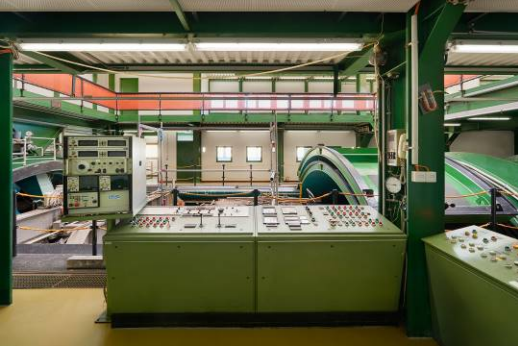
Umlauftank 2: Blick auf die Galerie mit gereinigten Seilen, Textilien und Böden. Foto: Philipp Lohöfener / Wüstenrot Stiftung
